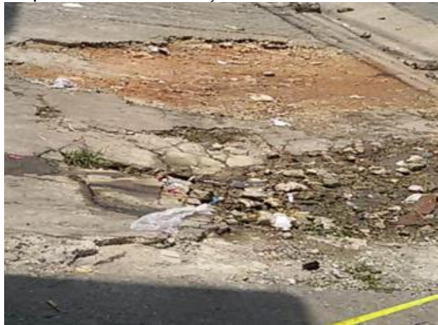
Figura 2: Calçada esburacada por falta de manutenção
