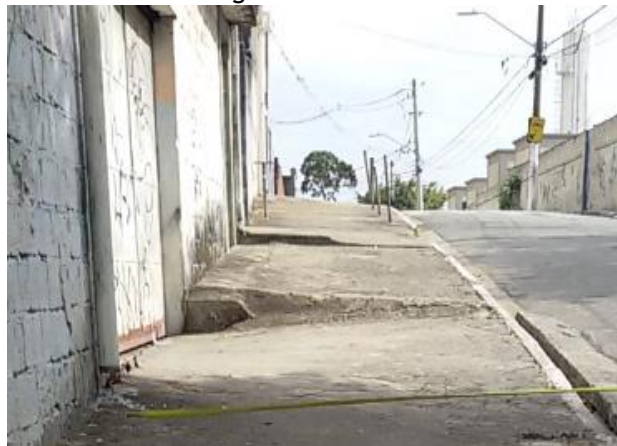
Figura 4: Desníveis nos perfis transversal e longitudinal.
