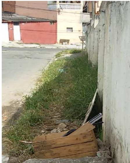
Figura 5: Calçada obstruída por mato e entulho
