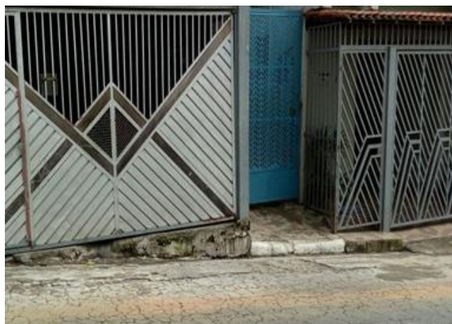
Figura 3: Calçada ocupada por morador, para ampliação da área útil do imóvel.
